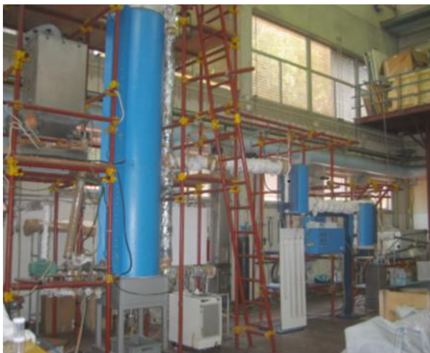
Figura 48. Instalação de gasificação e limpeza do gás de gasificação do LNEG.
