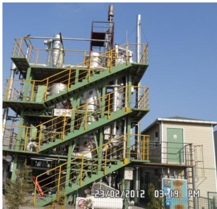
Figura 51. Foto da instalação de gasificação de leito fluidizado circulante de 150 kWth da TUBITAK.
