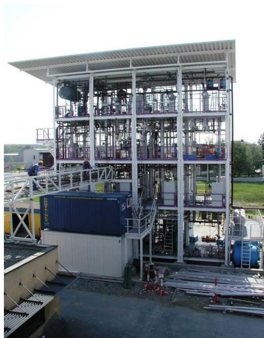
B- Instalação de conversão em metano.
