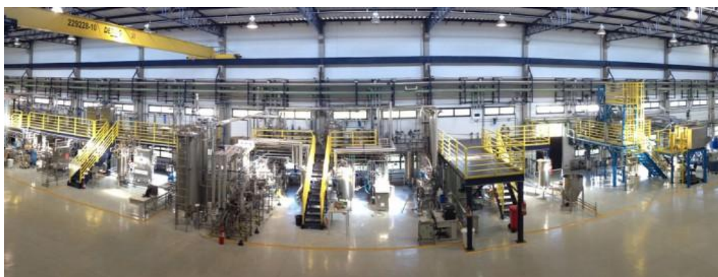
Figura 1 - Visão panorâmica da planta piloto do CTBE em Campinas, SP.
